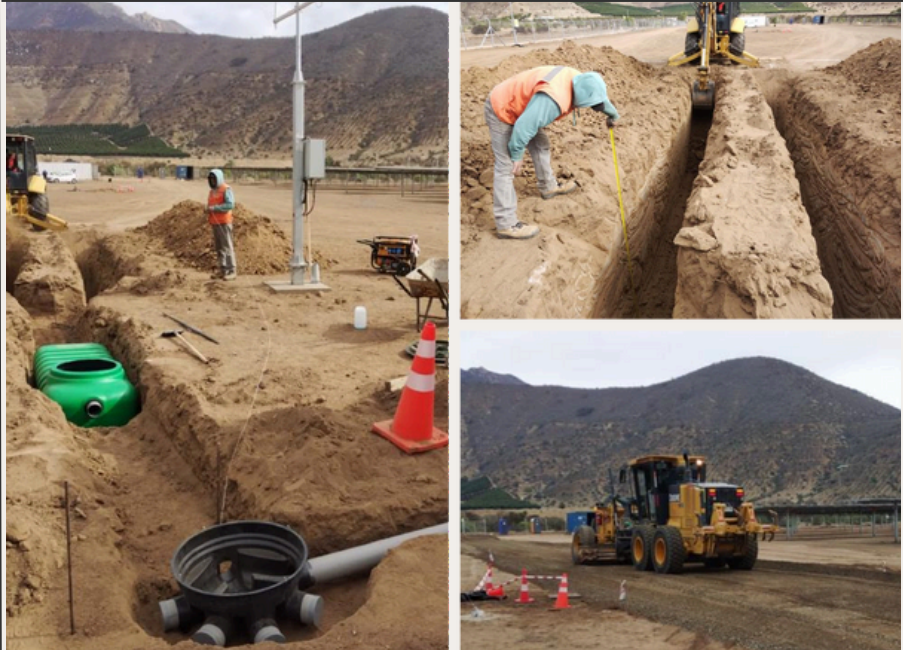
SANEAMIENTO PARQUE FOTOVOLTAICO EL TIJERAL, MANDANTE GEOM SPA
